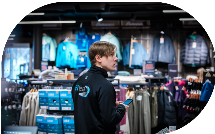
Optimalisering av lyset i sportsbutikk etter armaturbytte.
